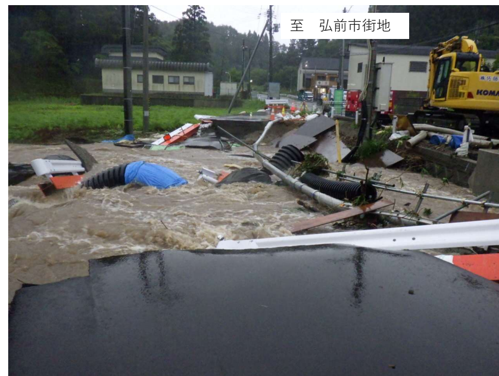
被災した仮設道路
