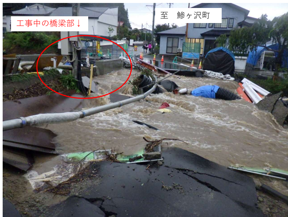
被災した仮設道路
