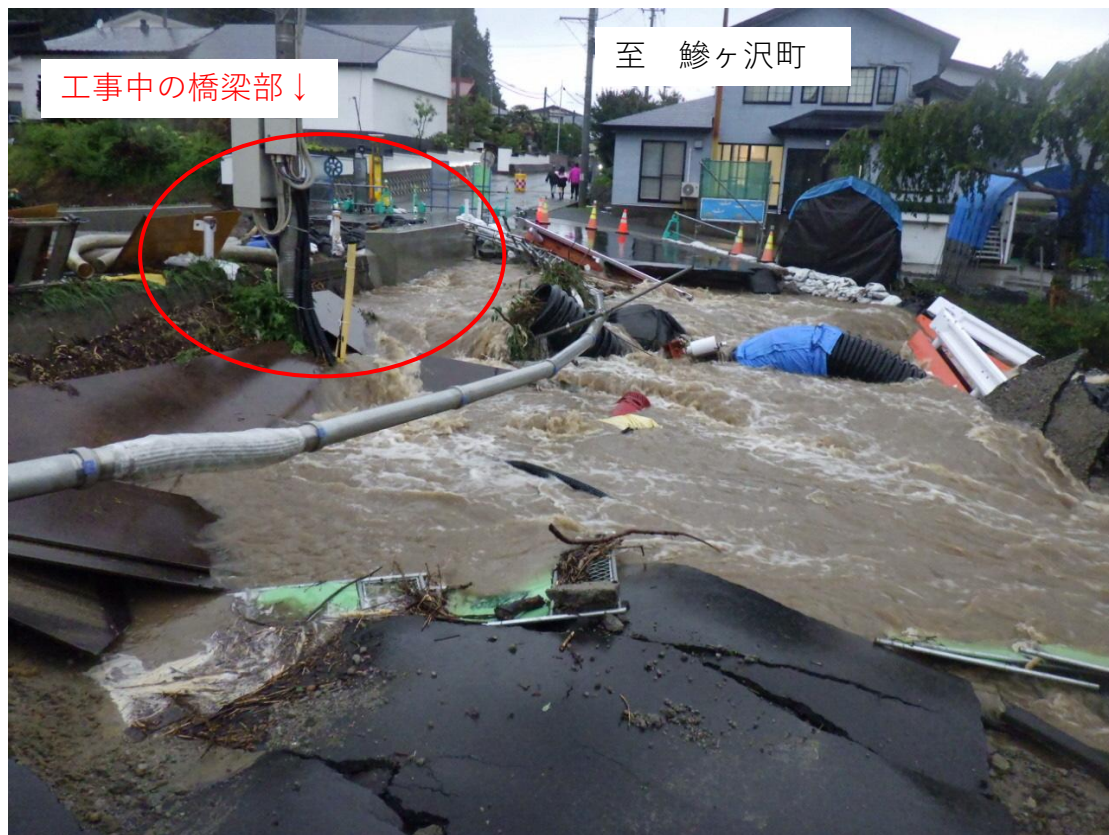
被災した仮設道路
