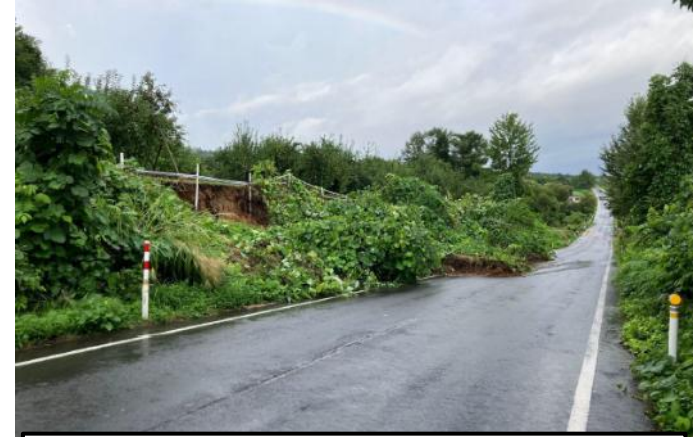
被害写真（大森字草薙地区）
